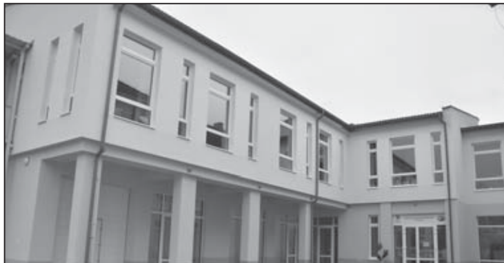
Podduklianske osvetové stredisko vo Svidníku zaznamenalo po ničivej prírodnej katastrofe praskliny na stenách, najmä v spojoch medzi novou a starou budovou a poškodené boli aj schody v starom objekte a obklady v budove prístavby...
